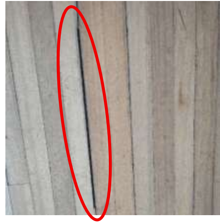
床の大きな亀裂
